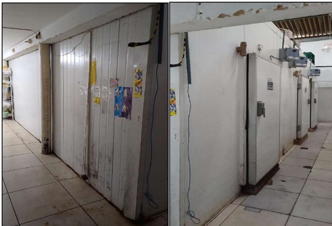
ITEM 0053 - CAMARA FRIA - ARMAZENAGEM - 3 PORTAS - 8,3X7,30 - 2,6 ALTURA
