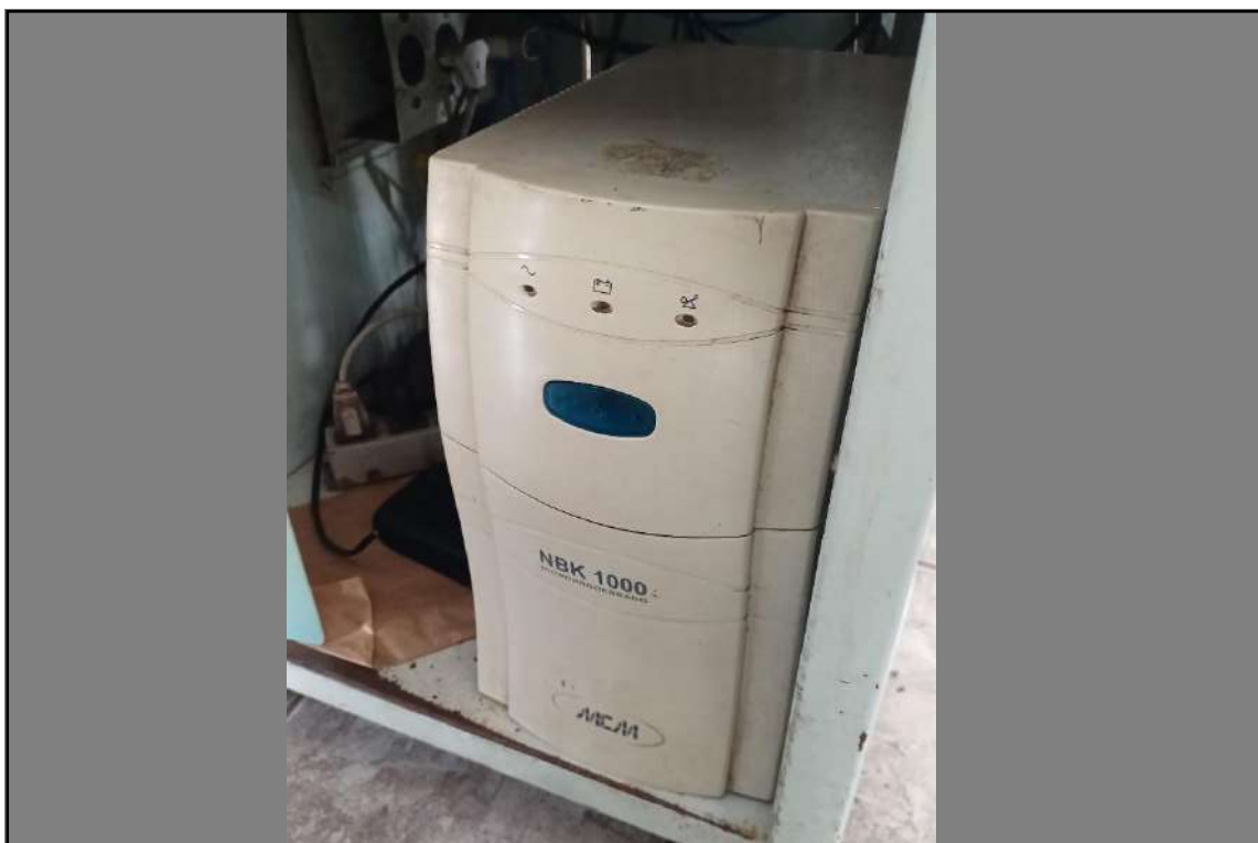
ITEM 0032 - NOBREAK - MCM
