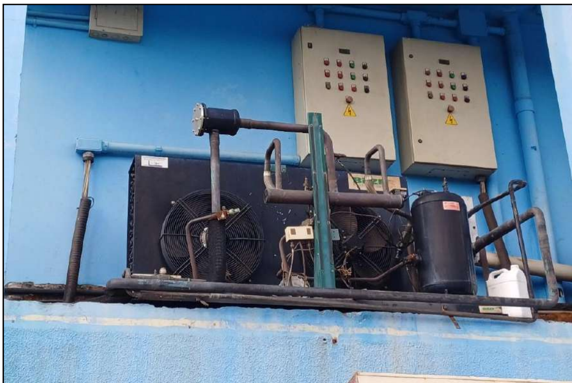
ITEM 0088 - MOTOR P/ GELADEIRA EXPOSITORAS - INATIVO - ÁREA EXTERNA
