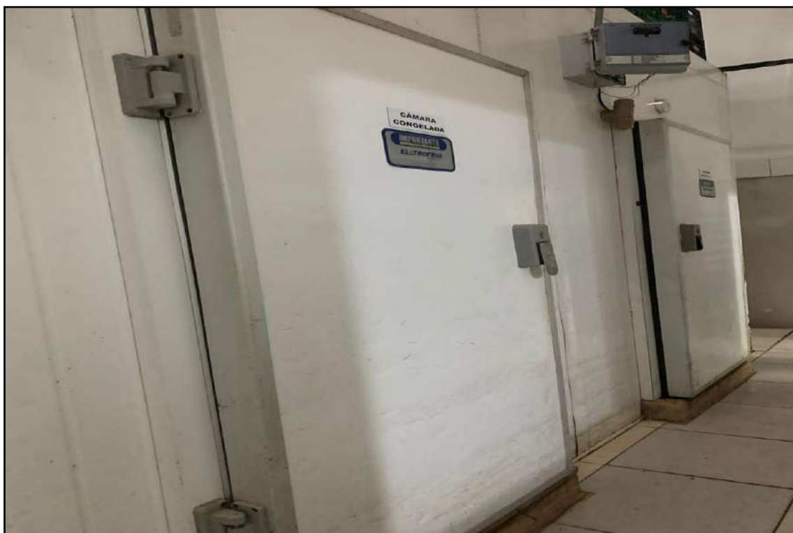
ITEM 0053 - CAMARA FRIA - ARMAZENAGEM - 3 PORTAS - 8,3X7,30 - 2,6 ALTURA
